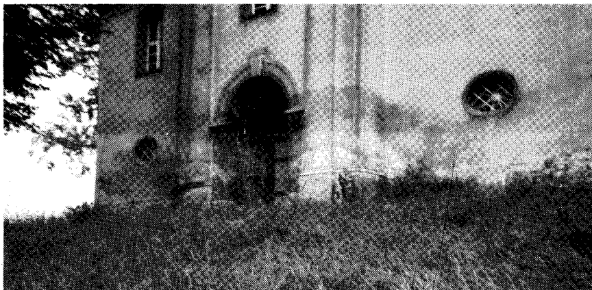
Die Beseitigung der aufsteigenden Nässe in den Außenmauern der Kirche sollen weitgehend beseitigt werden.
